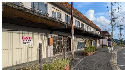
ロープをめぐらし「立入禁止」の廃店舗
